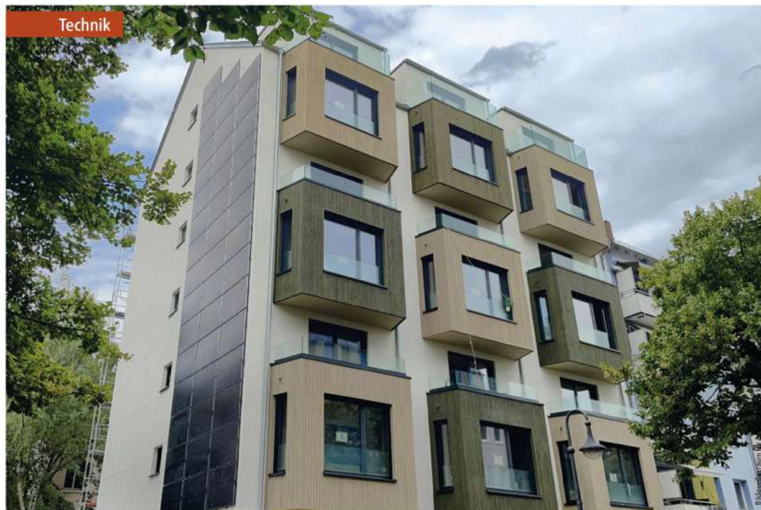
Die Sanierung des Siebengeschossers umfasste die energetische Ertüchtigung der Gebäudehülle, zudem wurden die Wohnungen an der Vorder- und Rückseite räumlich erweitert. Auch erhielt das Gebäude zwecks barrierefreier Wohnungszugänge an der Rückseite einen Aufzug in einem Schacht, beidseitig flankiert von neuen Balkonen.
